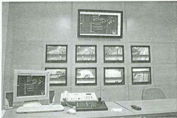
Sala de control para la vigilancia del complejo policial
